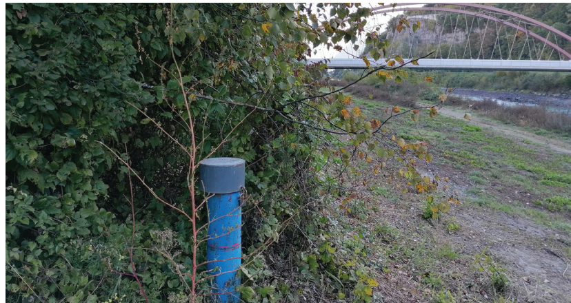
Exemple de piézomètre utilisé pour la surveillance des eaux souterraines.
